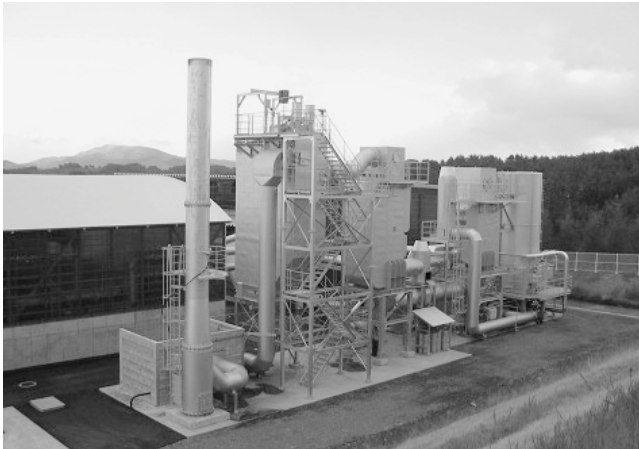
九戸地方ふるさと環境保全組合の排ガス処理装置
