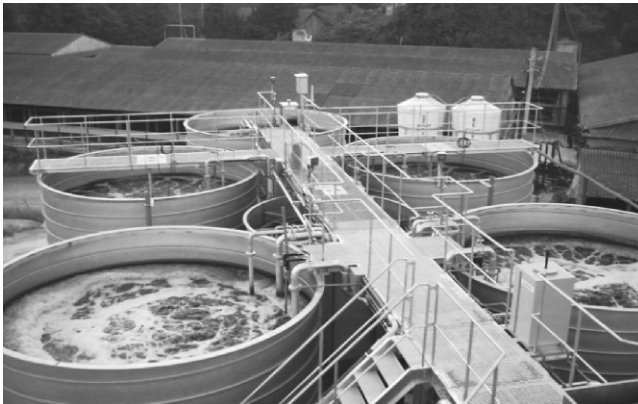
写真1 上：メタン発酵槽とガスホルダー 下：消化液の浄化処理設備
