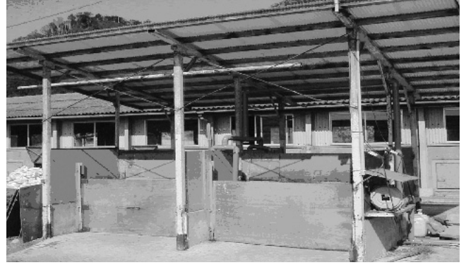
写真2 7m³の堆肥脱臭槽
