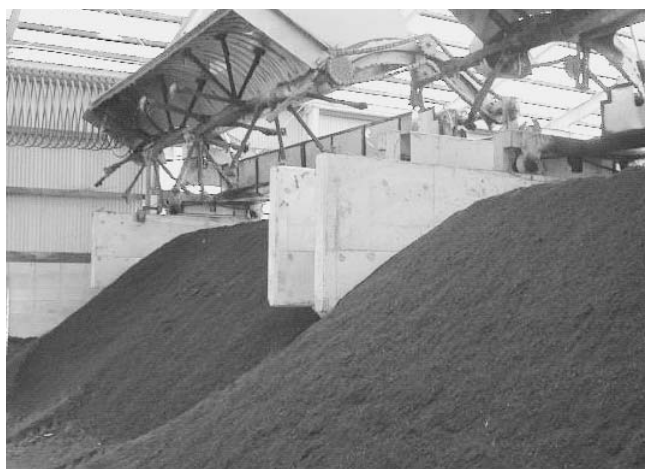
写真5 高梁市堆肥供給センターの直線開放型攪拌式発酵槽
